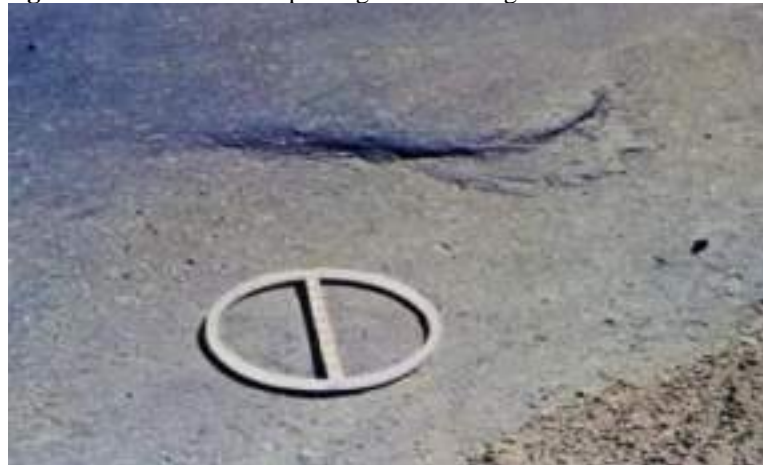
Figura 8: Pavimento com patologia de escorregamento em acostamento
