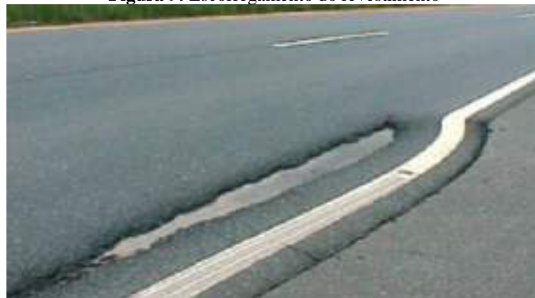
Figura 9: Escorregamento do revestimento
