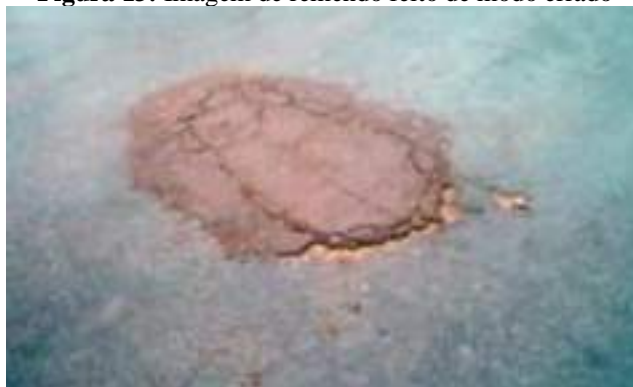
Figura 13: Imagem de remendo feito de modo errado
