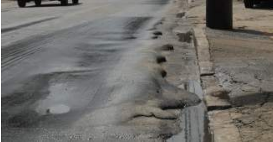
Figura 10: Pavimento com ondulações
