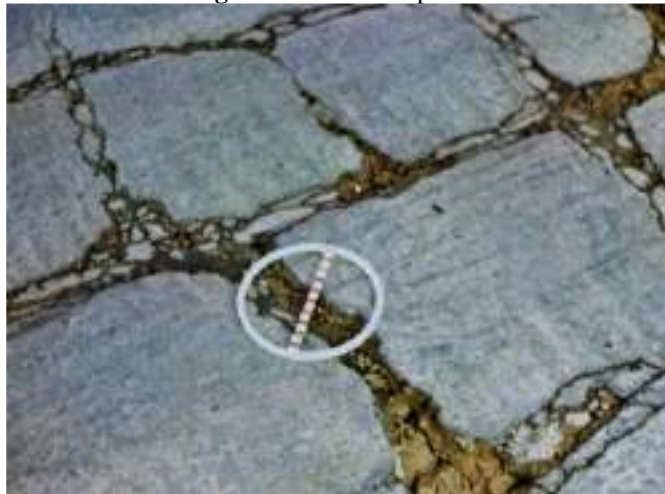
Figura 16: Trinca Tipo Bloco
