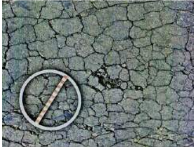
Figura 15: Trinca Tipo Couro de Jacaré
