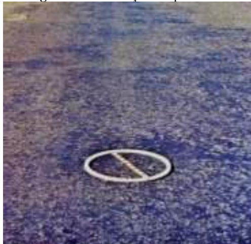
Figura 11: Exsudação em pavimento
