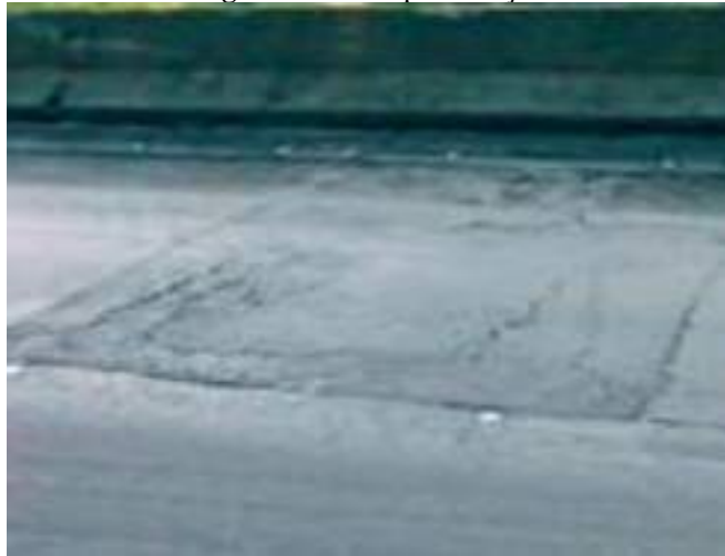
Figura 5: Trinca por retração
