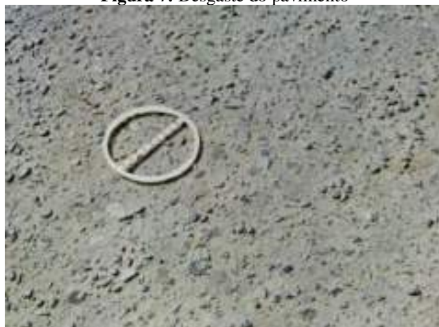
Figura 7: Desgaste do pavimento
