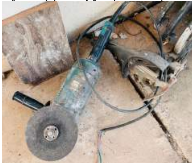
Figura 6: Equipamentos jogados pelo canteiro após o uso
