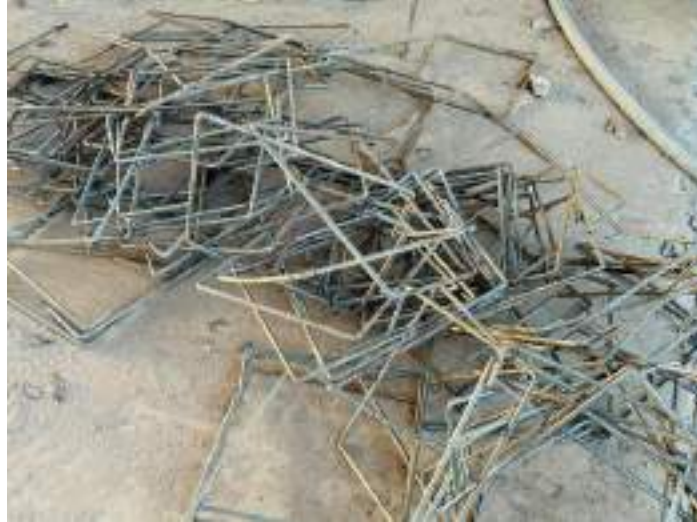
Figura 7: Materiais espalhados pelo canteiro, atrapalhando movimentação
