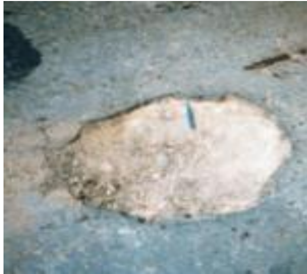
Figura 14 - Buraco ou Panela
