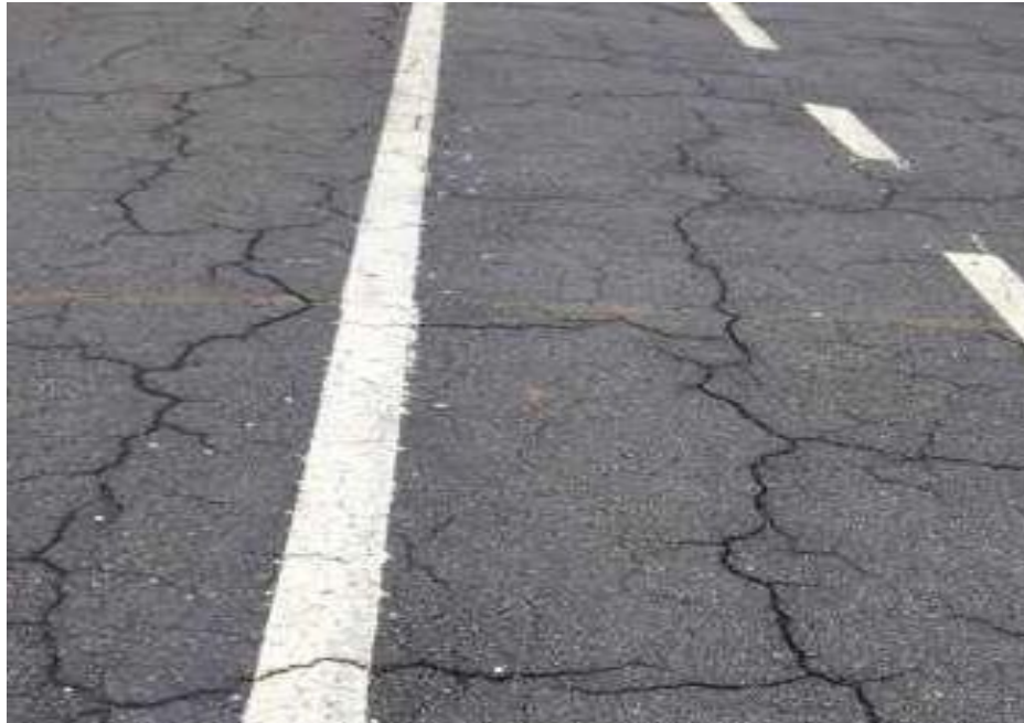
Figura 6 - Trinca em blocos
