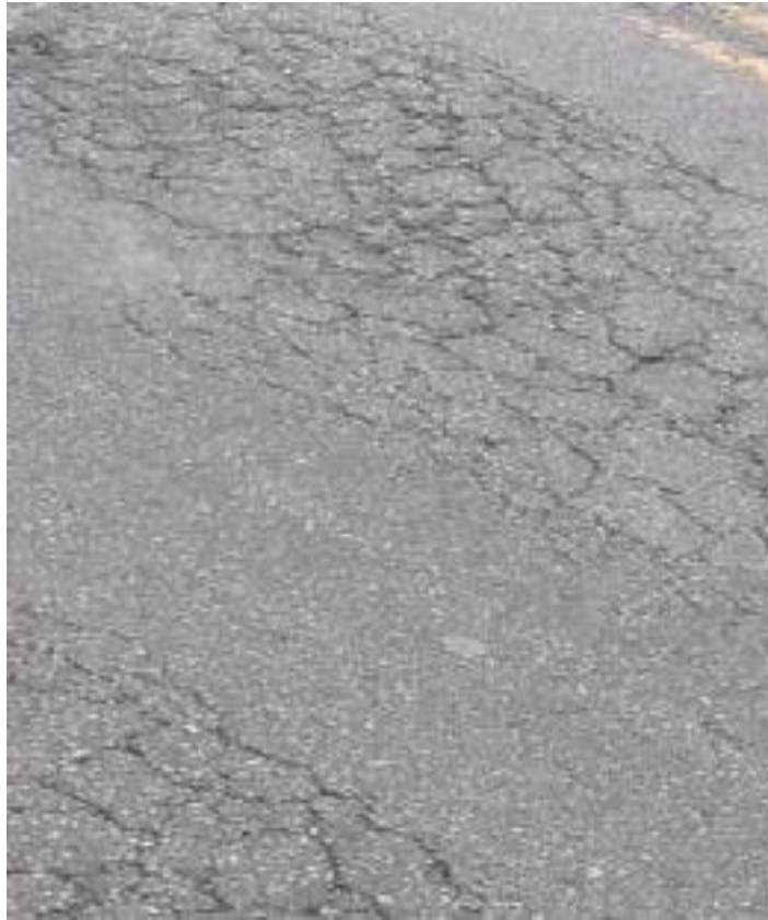
Figura 5 - Trinca por reflexão
