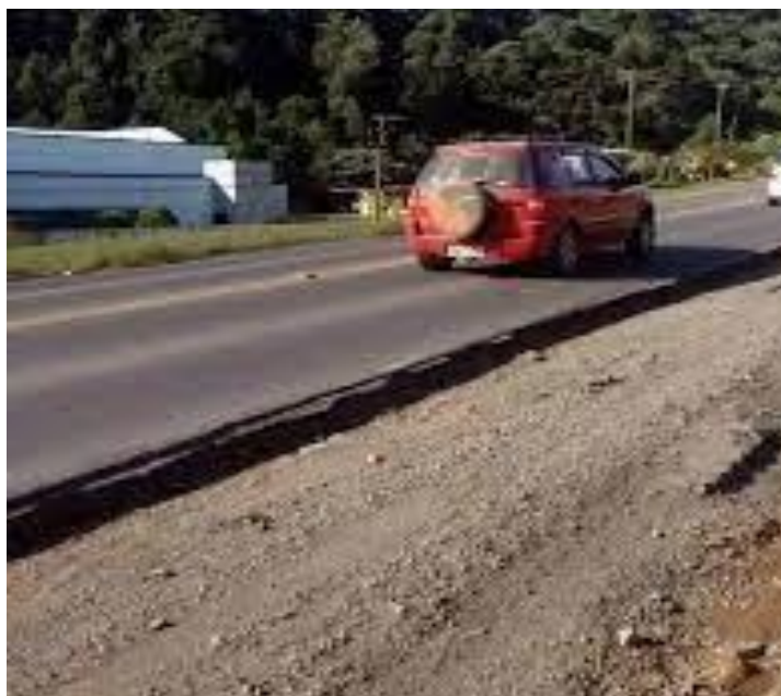
Figura 16 - Desnível entre a pista e acostamento
