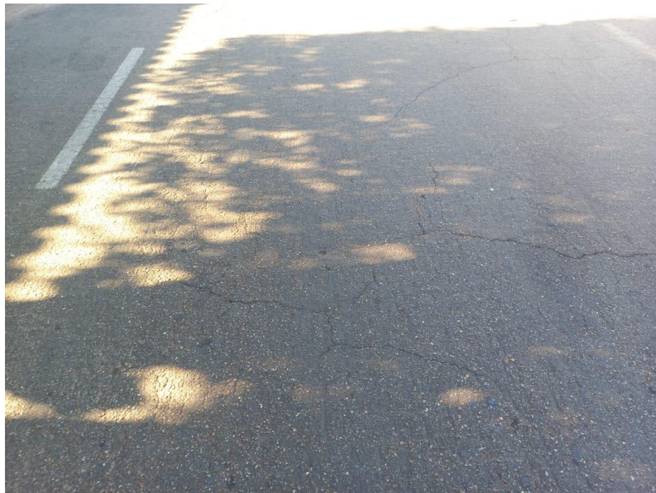
Figura 20- Defeito Avenida sete copa
