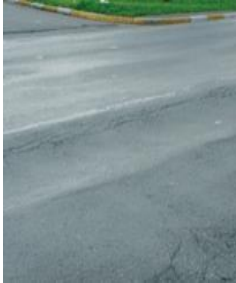
Figura 9 - Afundamento de trilha de roda
