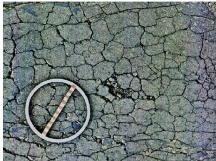
Figura 8 - Trinca couro de jacaré
