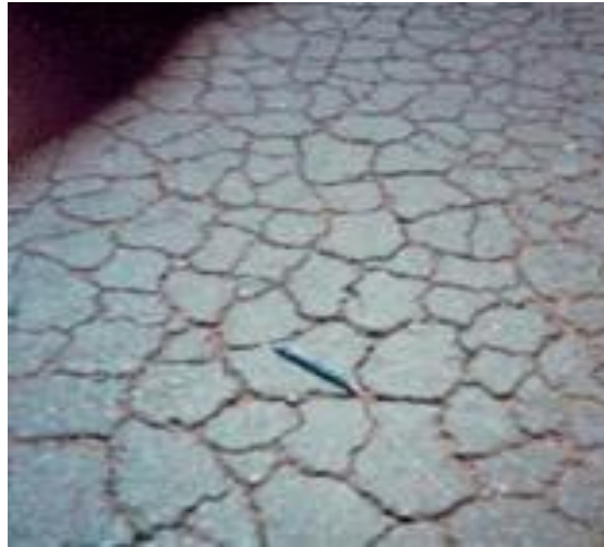
Figura 7 - Trinca couro de jacaré
