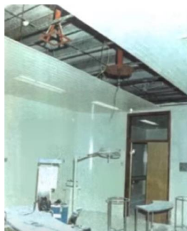
Figura 44: Situação precária/ motivos do fechamento temporário da Clínica de Tumores de Radioterapia do Centro-Oeste/MT, 1977.
