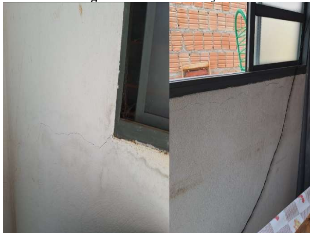
Fotografia 3: Fissuras em janelas.
