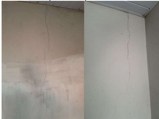
Fotografia 4: trincas causadas por deformações estruturais em diferentes residências.
