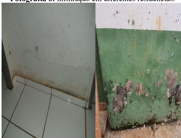
Fotografia 6: infiltração em diferentes residências.
