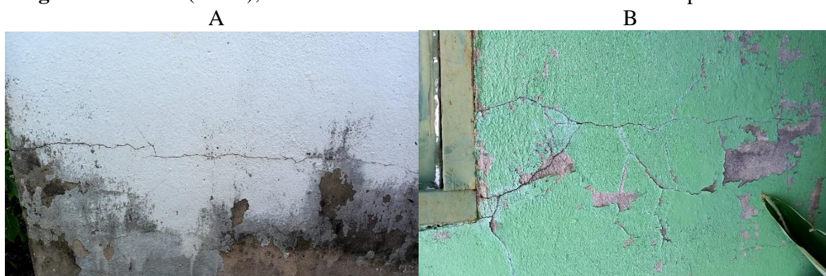
Figura 7: fissuras (A e B), onde estão localizadas na fachada da casa e na parede da sala.
